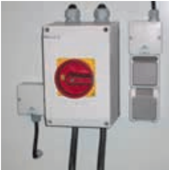
Wartungsschalter mit Verkabelung zur Motorklemmdose für Kaltleiter.
