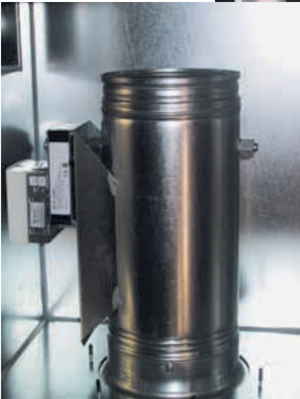
Volumenstromregler im Gerät installiert
