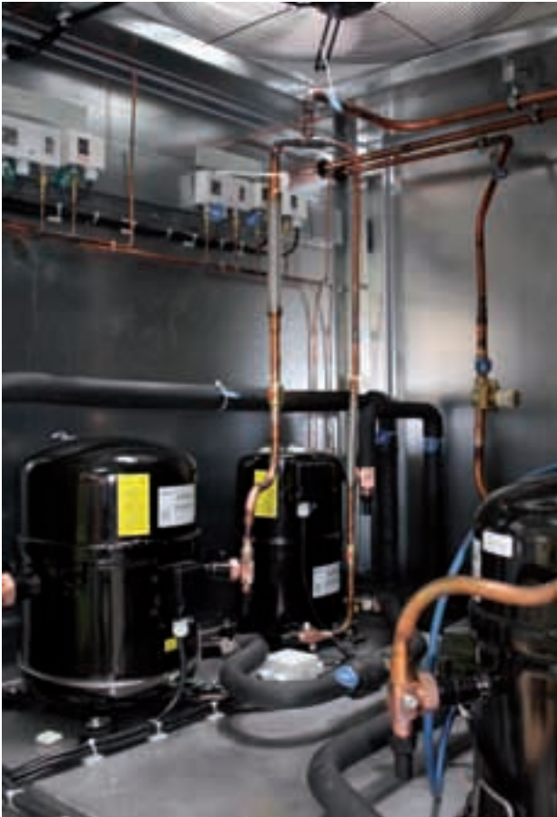
Kälteanlage wartungsfreundlich vom Luftstrom getrennt eingebaut.
