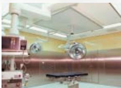
Zuluftdecke für OP-Räume
