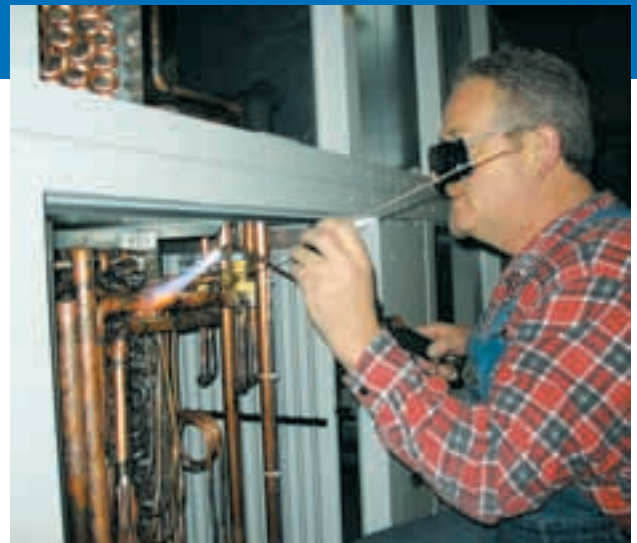
Die Herstellung und der Einbau der Kältekreise erfolgt durch eigenes, qualifiziertes und erfahrenes Fachpersonal, nach individuell erstellten Kälteschemata.
