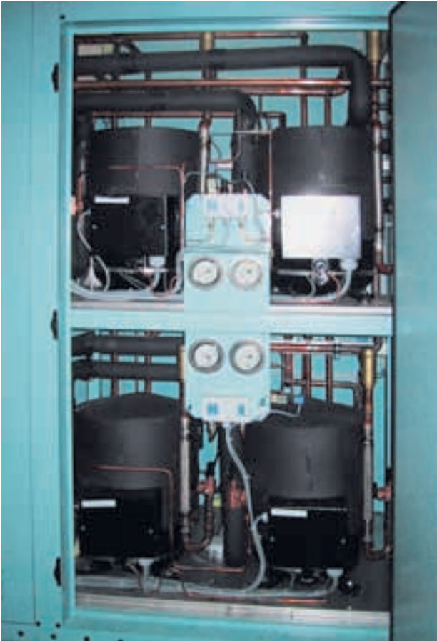
Kälteanlage wartungsfreundlich vom Luftstrom getrennt eingebaut.
