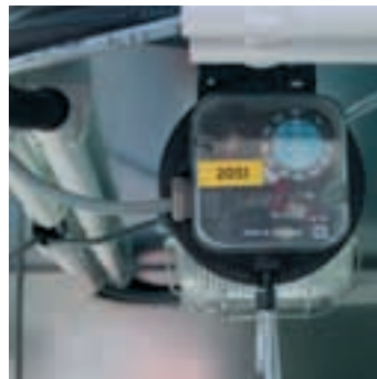
Druckschalter zur Filterüberwachung und Ventilatorüberwachung.
